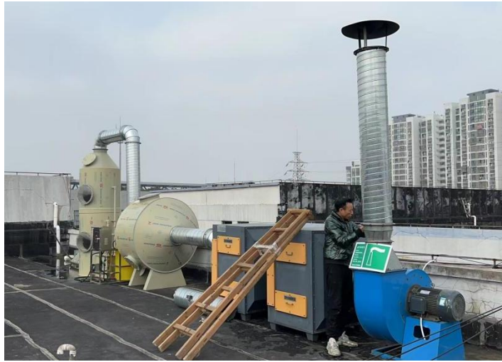
废气处理（碱喷淋+除雾器+二级活性炭+15m 高 1#排气筒）
