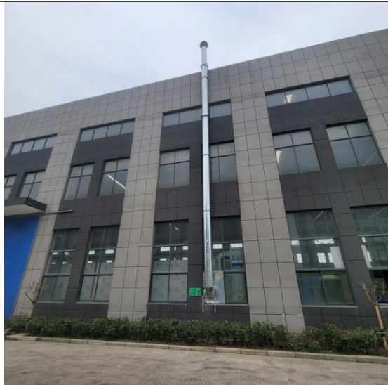
布袋除尘器+15m 高 3#排气筒
