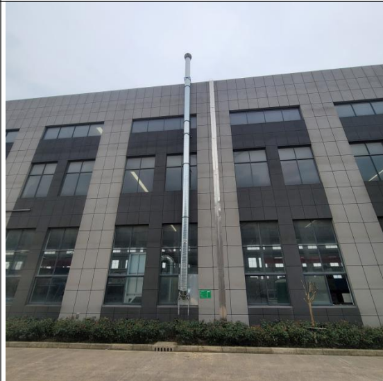
布袋除尘器+15m 高 4#排气筒
